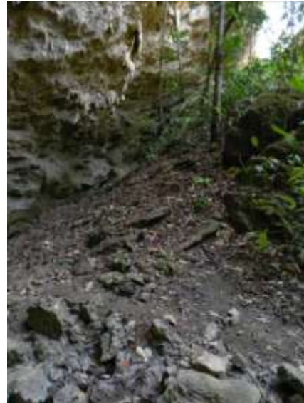
Foto 113/III - Processos erosivos-gravitacionais presentes na entrada da gruta
